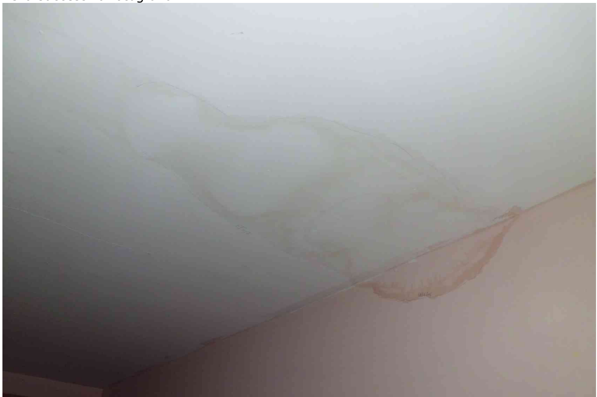
Foto n° 15 - 18/04/2016 - Comune di Pordenone, foglio 13, part. 581, sub. 69 - Camera da letto matrimoniale. Macchie di umidità, presumibilmente causate dalla rottura di una tubazione al piano superiore.
