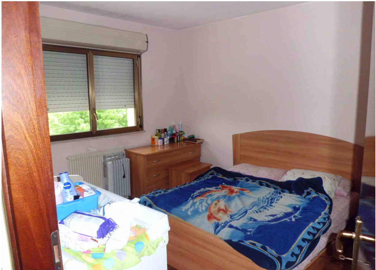
Foto n° 14 - 18/04/2016 - Comune di Pordenone, foglio 13, part. 581, sub. 69 - Camera da letto matrimoniale. Sul soffitto sono presenti danneggiamenti dovuti all'umidità, visibili nella successiva fotografia.
