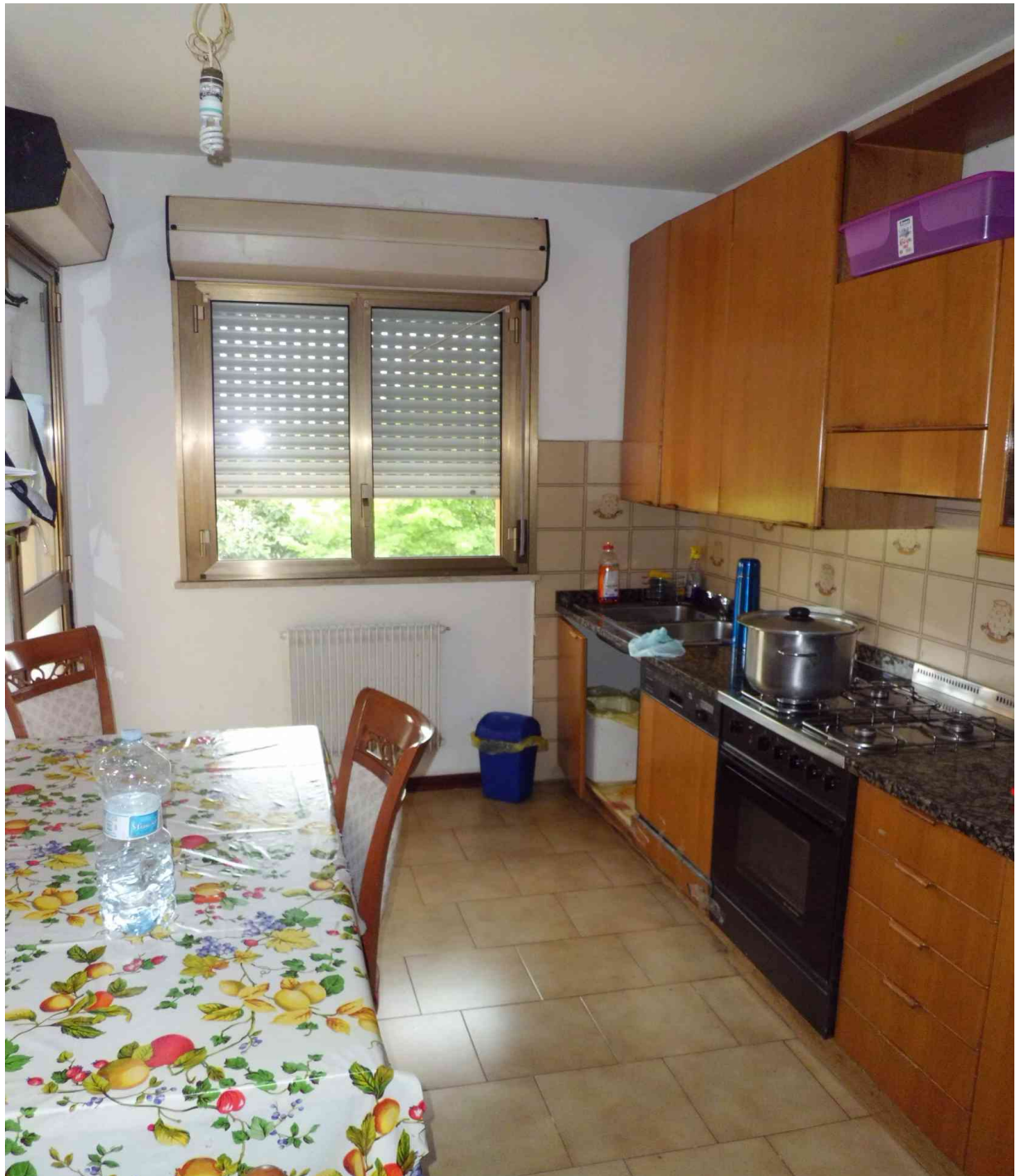
Foto n° 9 - 18/04/2016 - Comune di Pordenone, foglio 13, part. 581, sub. 69 - Stanza adibita a cucina. In fondo sulla sinistra è visibile la posta-finestra che da accesso alla terrazza della foto precedente. Sul soffitto sono presenti macchie di umidità, presumibilmente causate dalla rottura di una tubazione al piano superiore.
