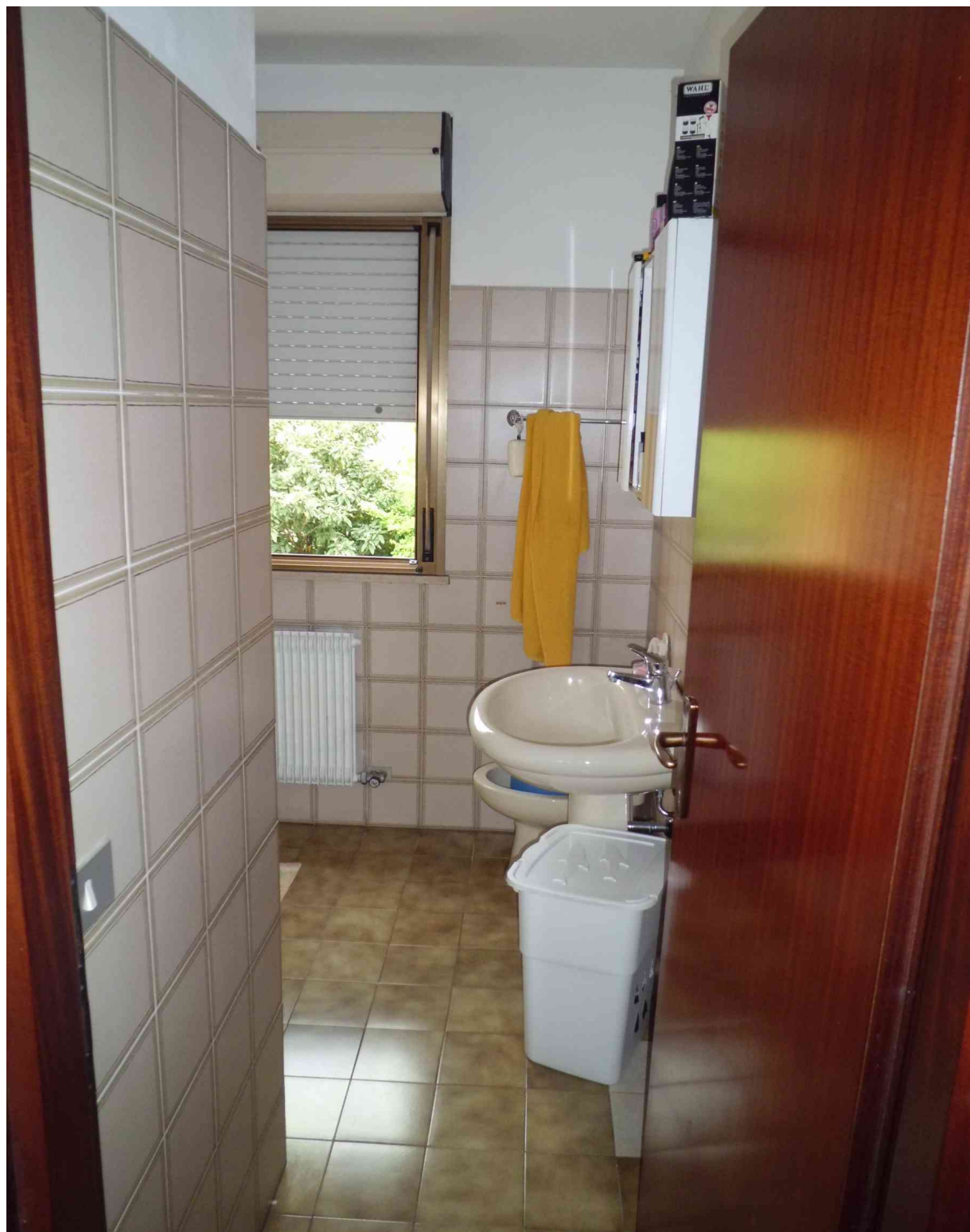
Foto n° 15 - 18/04/2016 - Comune di Pordenone, foglio 13, part. 581, sub. 69 - Bagno principale dotato di vasca, wc, lavandino e bidet. Confinante con la camera matrimoniale e la cucina, anche in questa stanza sono visibili macchie di umidità sul soffitto.
