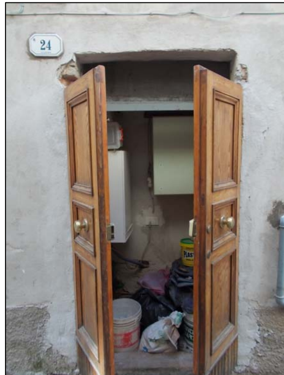
Foto n.4 Vano caldaia Via Luigi Masi n. 24
