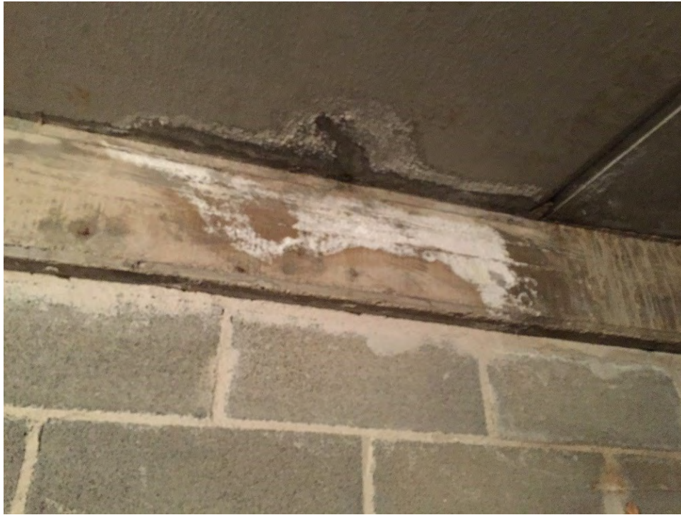
Infiltrazioni presenti nel garage
