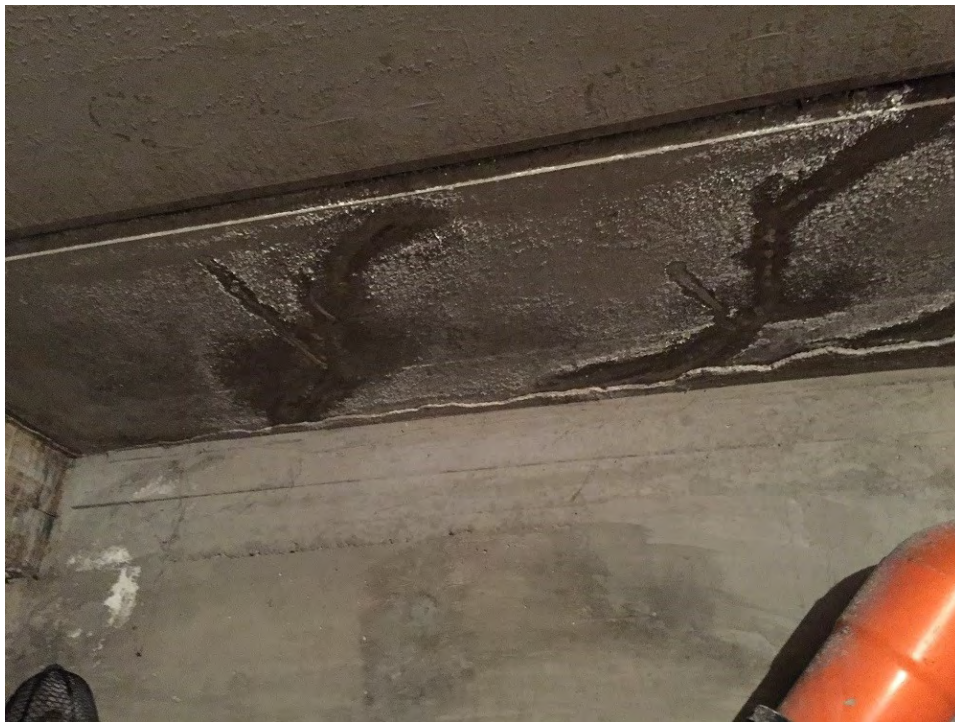
Infiltrazioni presenti nel garage
