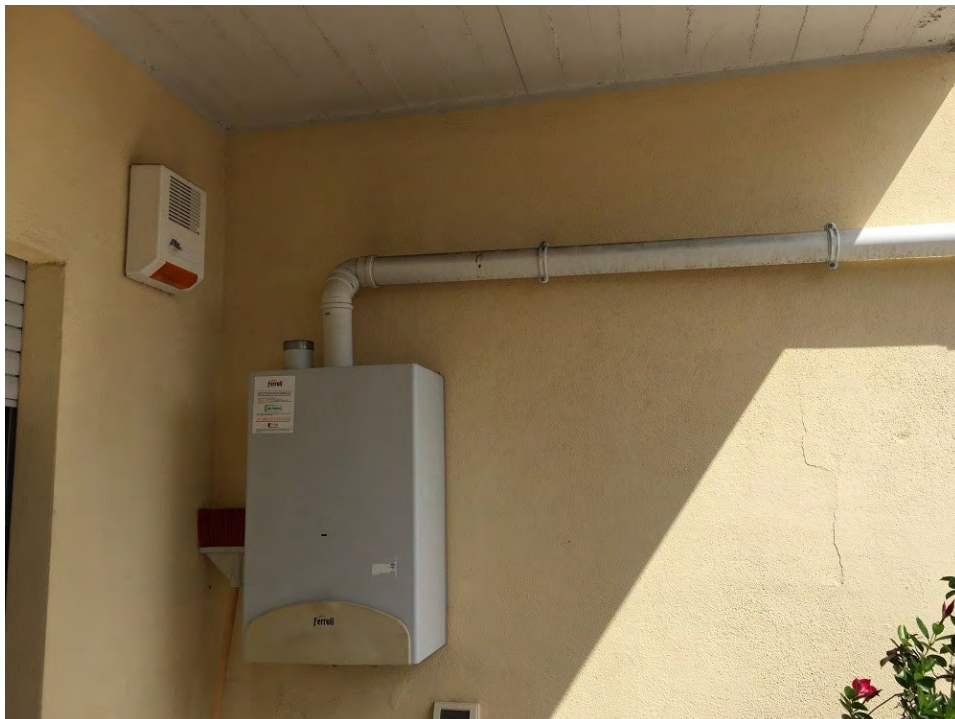
Centrale termica indipendente
