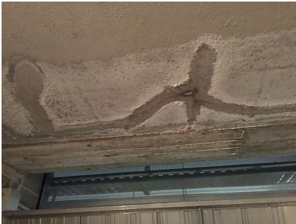
Infiltrazioni presenti nel garage
