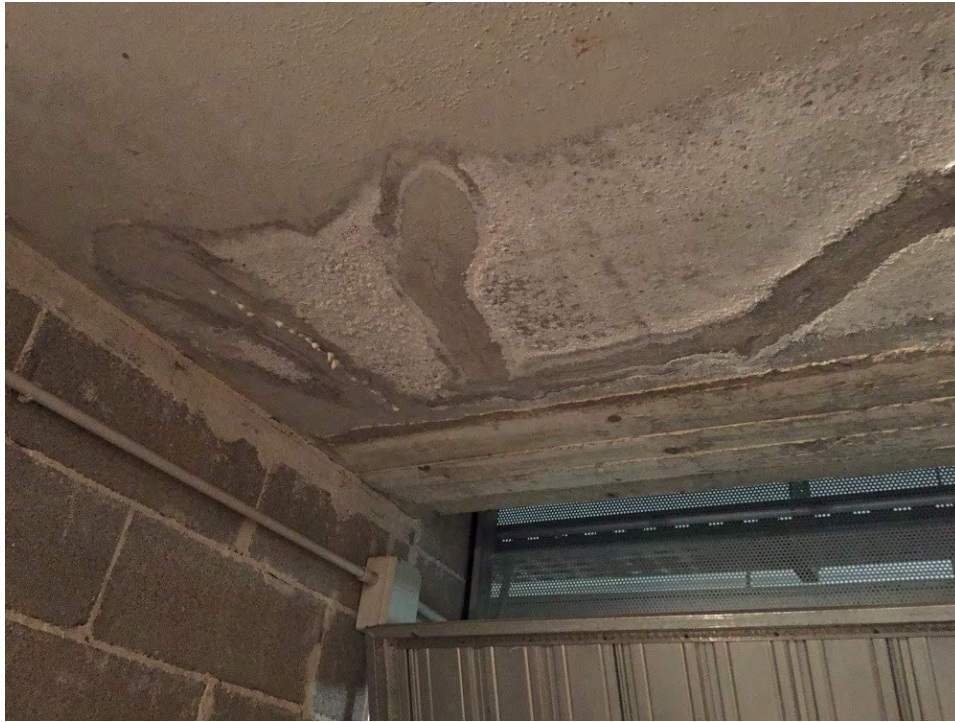
Infiltrazioni presenti nel garage
