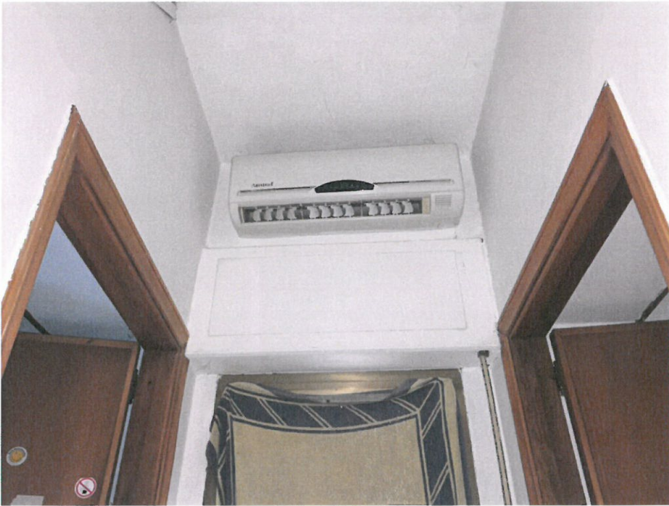
Foto n.21 - Condizionatore su disimpegno piano primo
