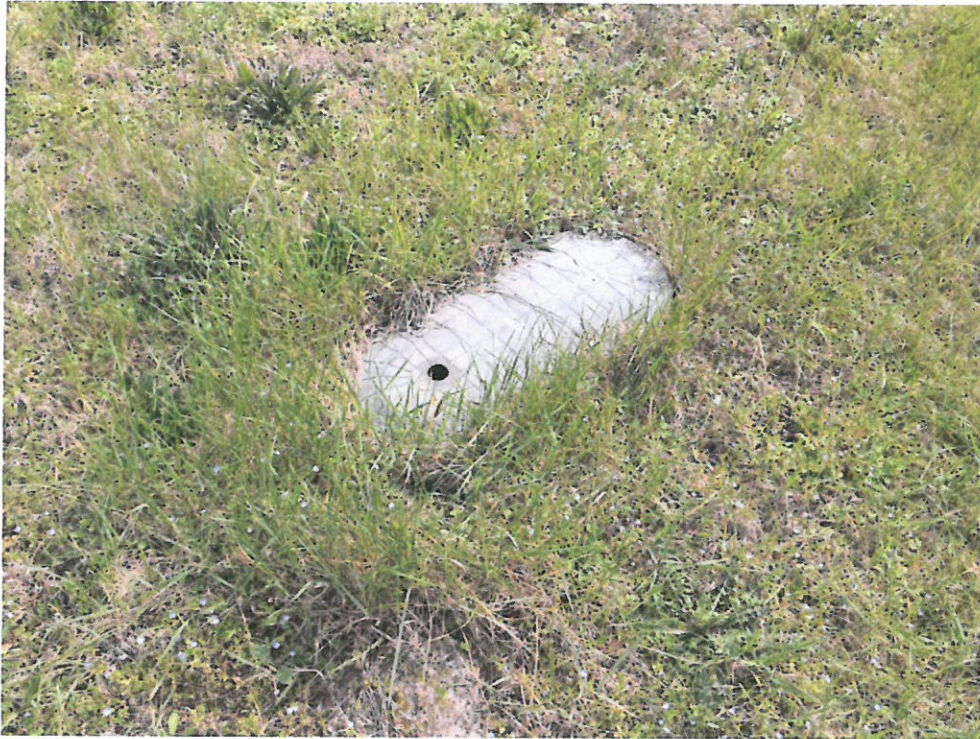
Foto n.07 - Particella n.29, bombolone del gpl interrato
