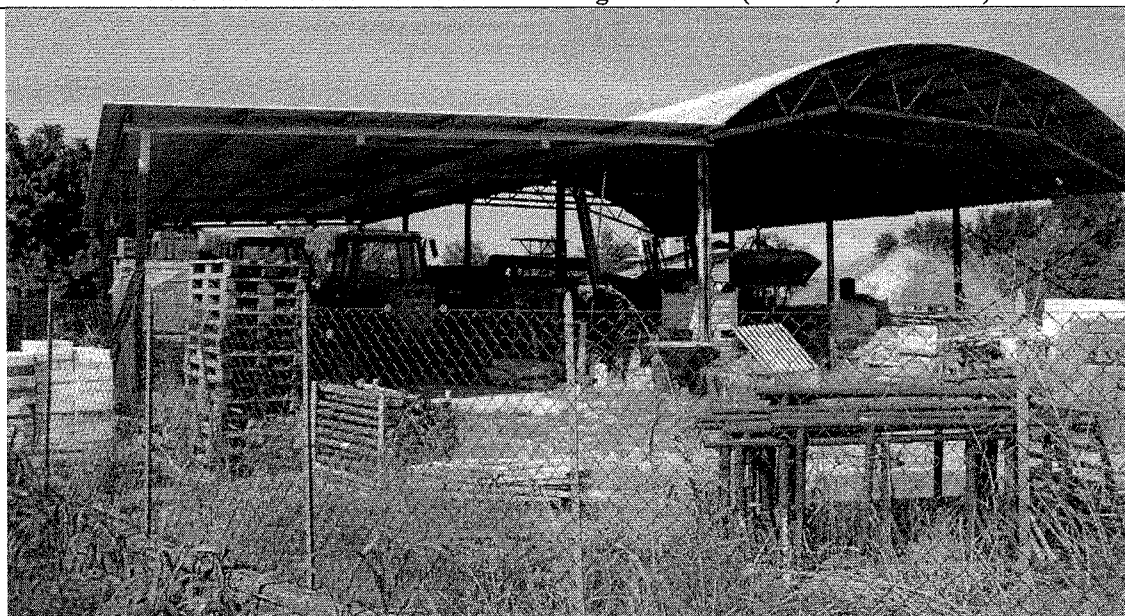
Foto 2.15 – vista da est della tettoia/magazzino "D" (abusivo, da demolire)
