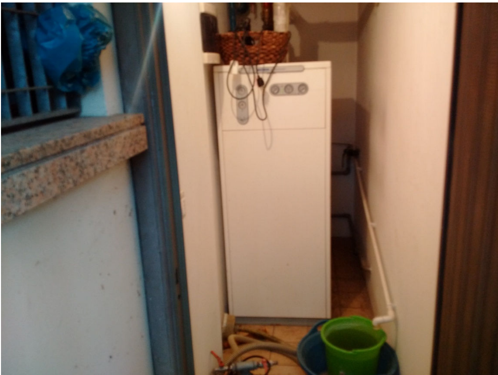
Foto n. 44 – Locale caldaia – piano seminterrato.
