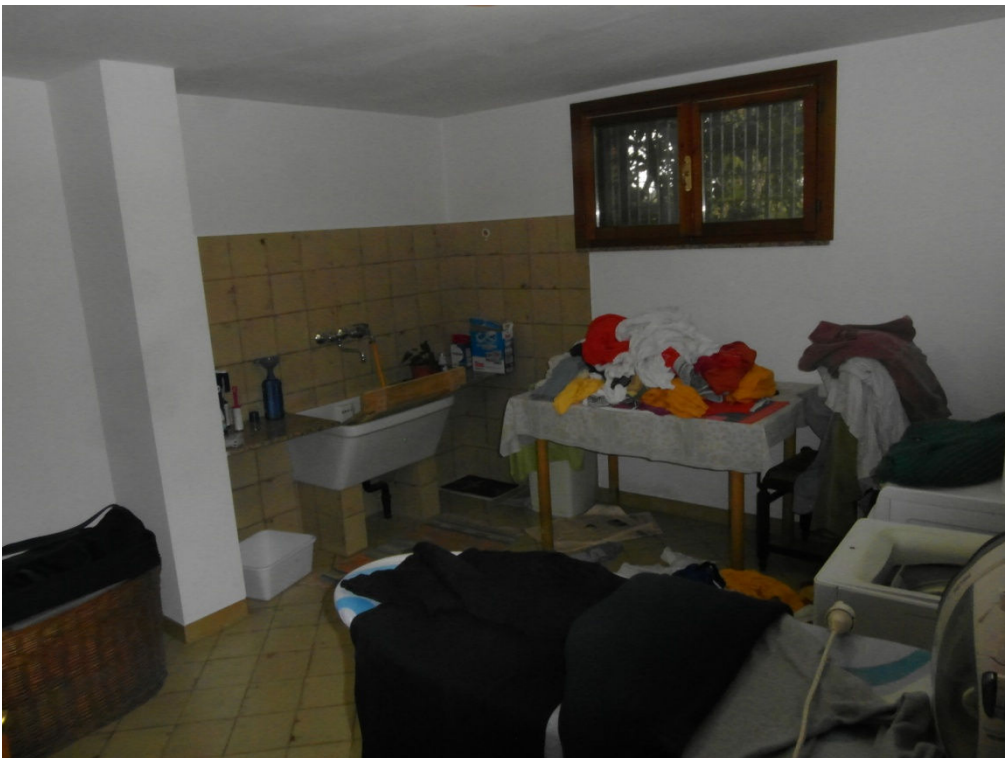
Foto n. 38 – Lavanderia piano interrato.
