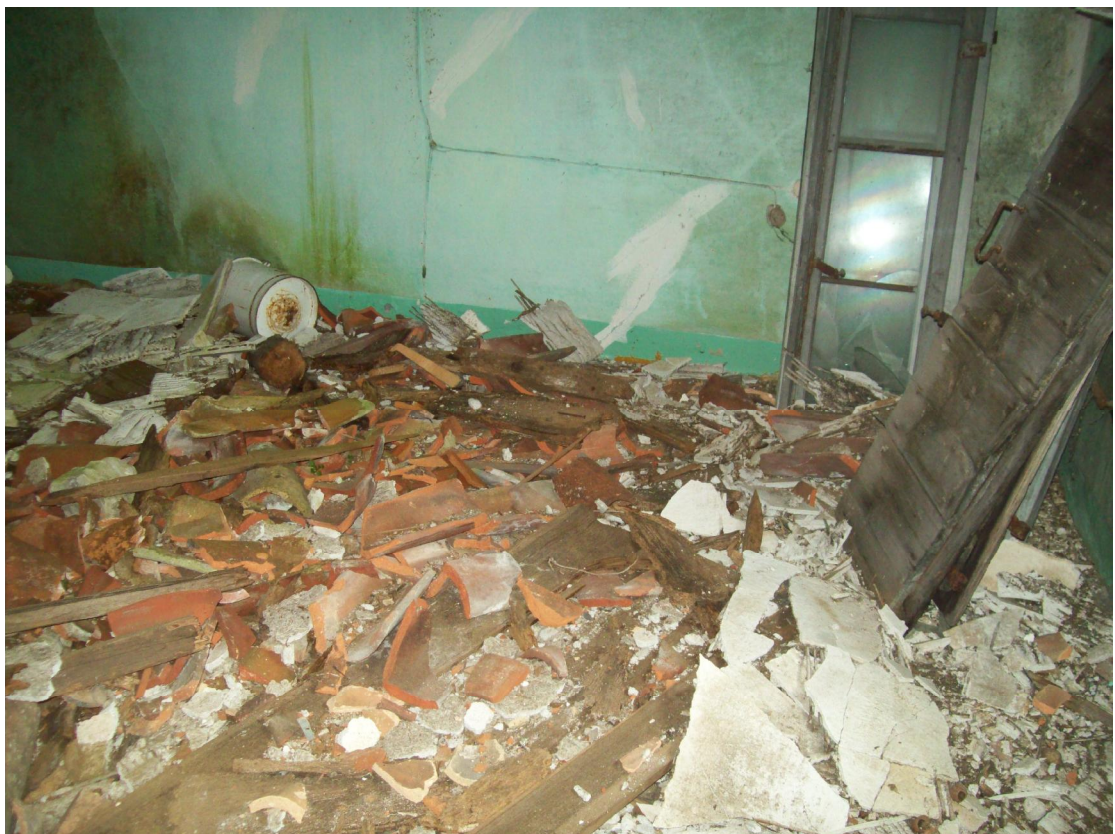
Foto 32: Detriti sul solaio
