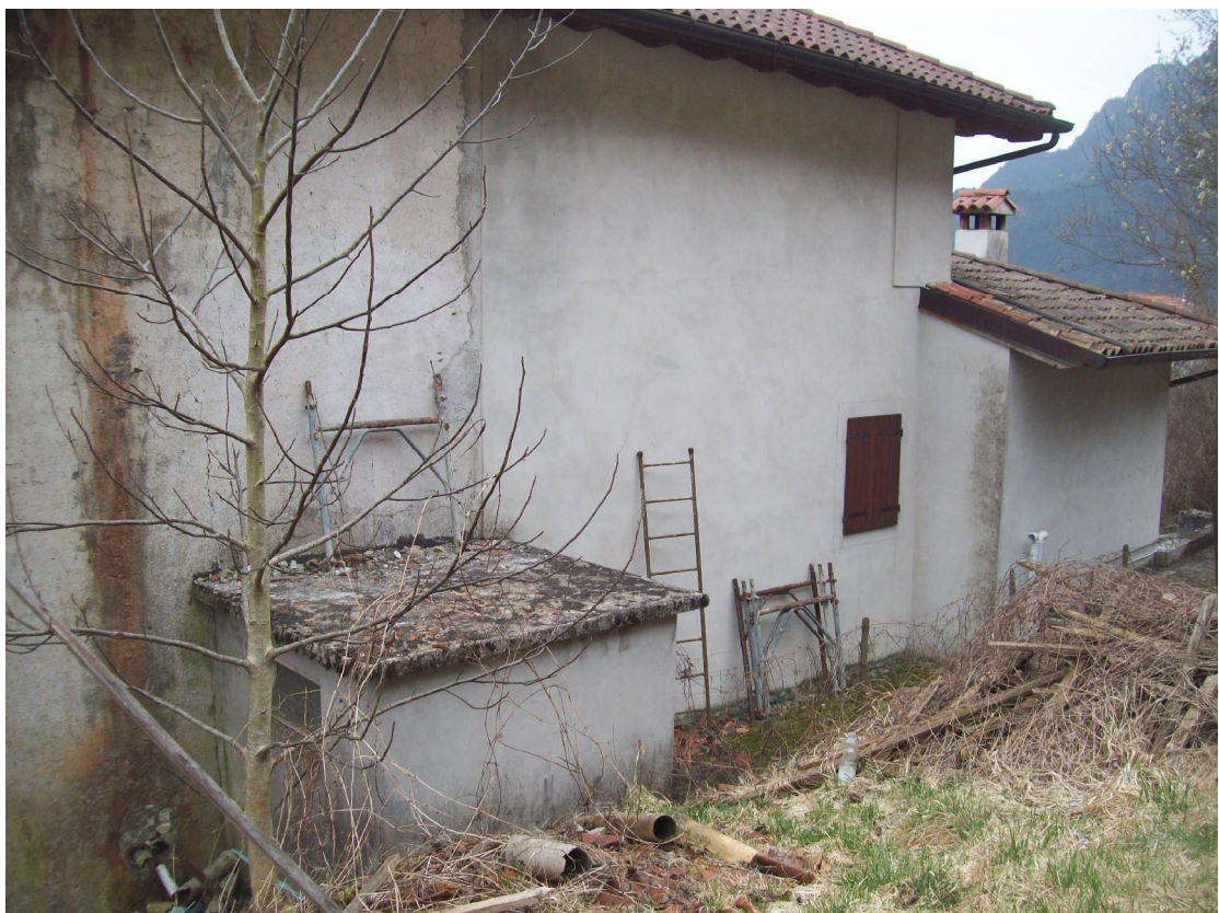
Foto 8: Corpo sul retro contiguo ad altra proprietà
