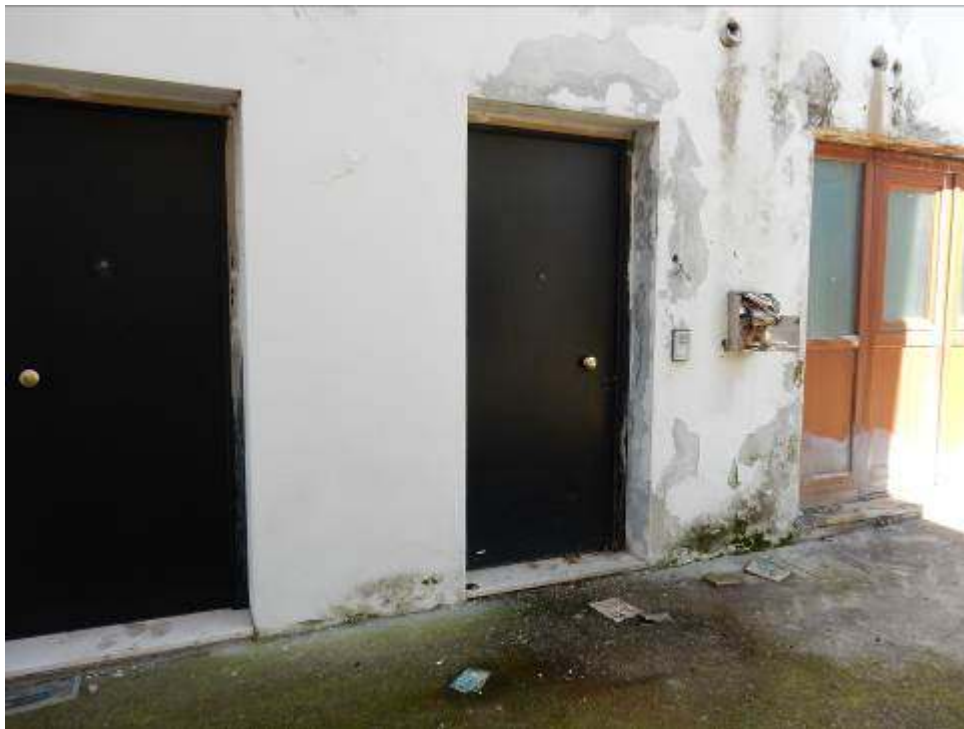
Foto 43-44: Parete esterna lato Sud e portone garage.
