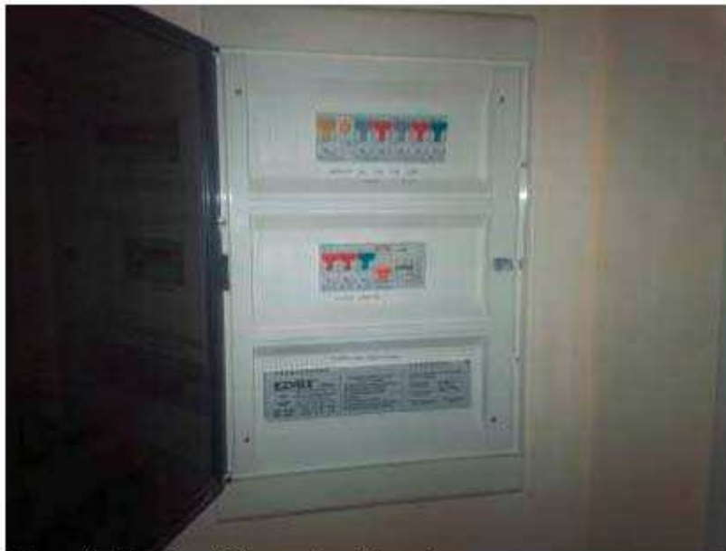
Foto n. 45 – Quadro elettrico posto al piano terra.
