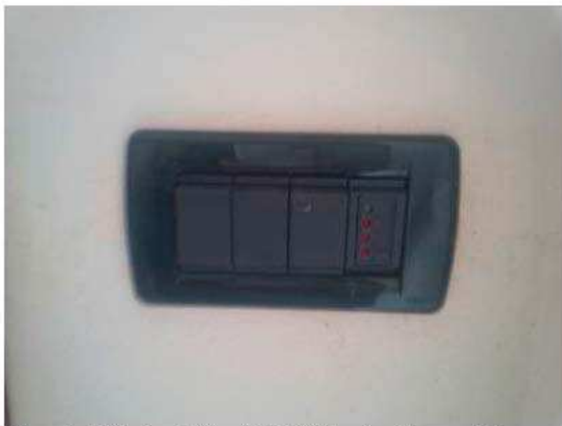
Foto n. 46 – Dettaglio serie interruttori di fabbricazione Vimar mod. Plano.
