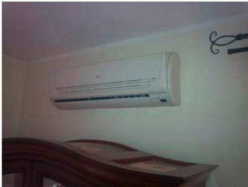
Foto n. 49 – Dettaglio impianto di climatizzazione – Split interno del soggiorno.
