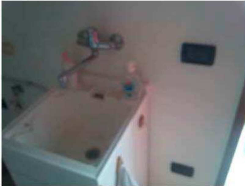
Foto n. 19 - Locale caldaia, uso lavanderia.
