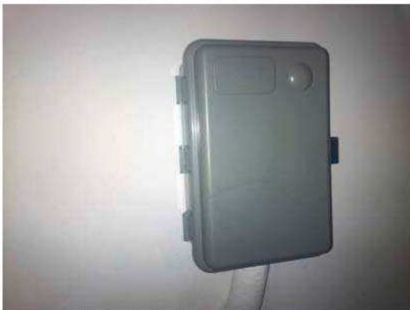
Foto n. 48 – Dettaglio centralina dell'impianto di irrigazione.
