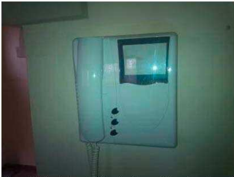
Foto n. 47 – Videocitofono di fabbricazione Evax posto in cucina al piano terra.
