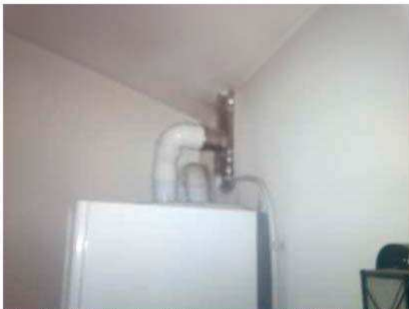
Foto n. 18 - Centrale termica. Caldaia murale a gas, di fabbricazione TATA mod. Simla.
