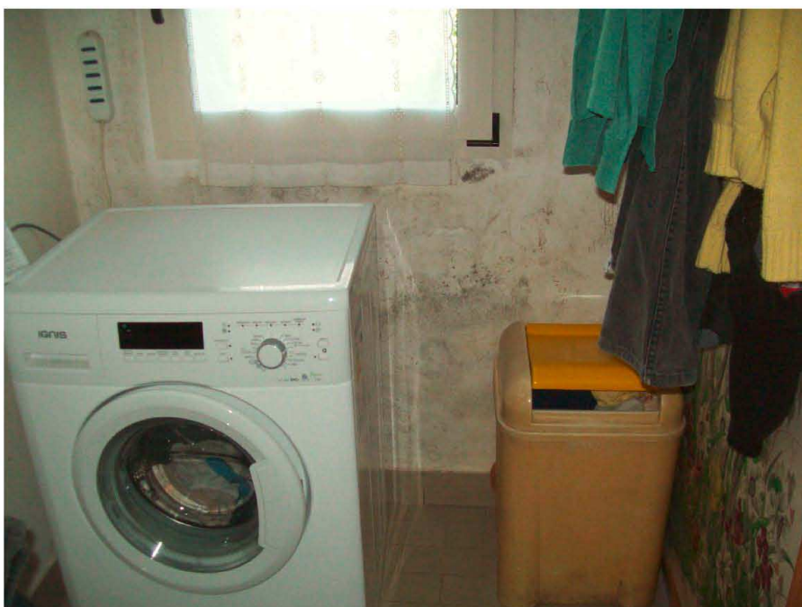
Foto 12: Lavanderia e C.t. al piano terra con muffe
