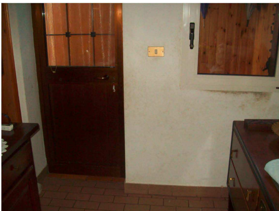
Foto 10: Particolare muffa atrio al piano terra
