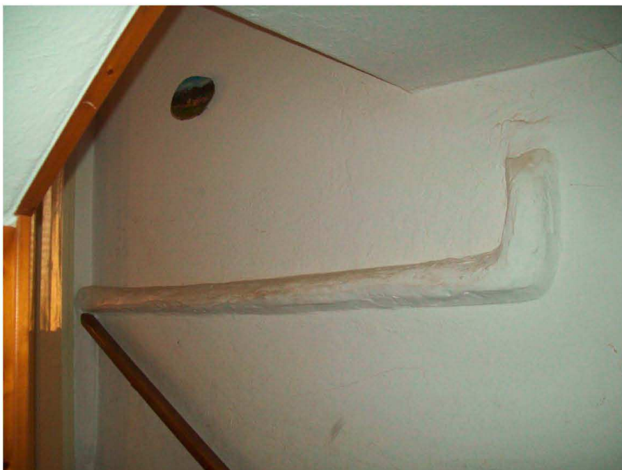
Foto 14: Particolare tubazioni esterne piano terra
