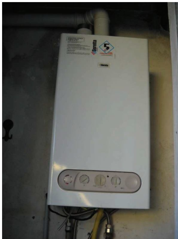
Foto 42 - 43 atrio/ripostiglio e caldaia
