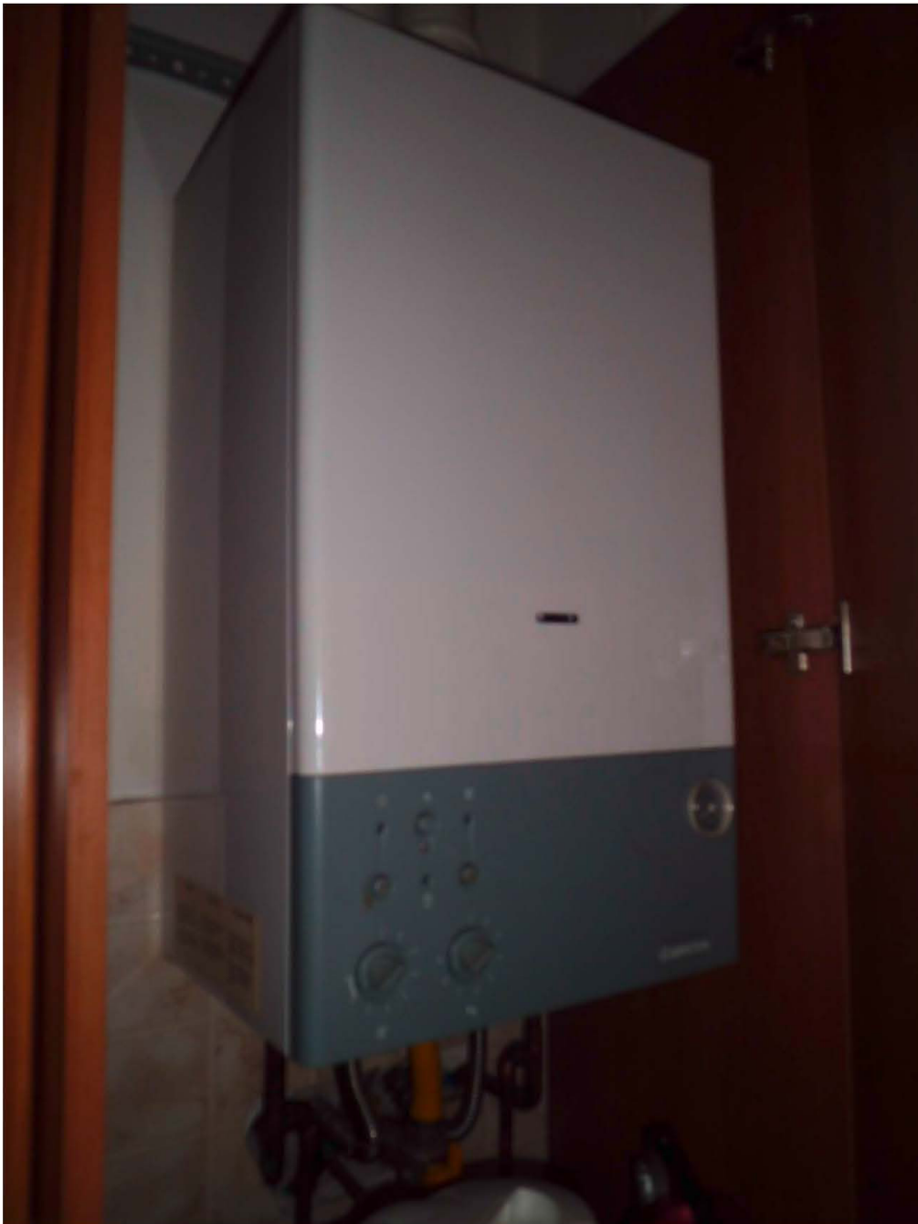
Foto n° 13 - 19/02/2015 - Comune di Pravisdomini - Foglio 11 part. 495 sub.10 - Impianto di riscaldamento: caldaia murale posta all'interno di un armadio nell'angolo cottura del soggiorno.
