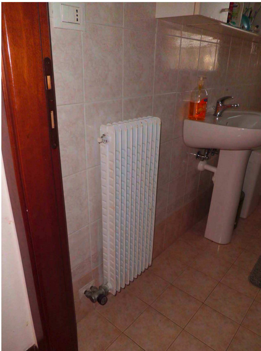
Foto n° 14 - 19/02/2015 - Comune di Pravisdomini - Foglio 11 part. 495 sub.10 - Impianto di riscaldamento: radiatore lamellare posto all'interno del vano uso bagno .
