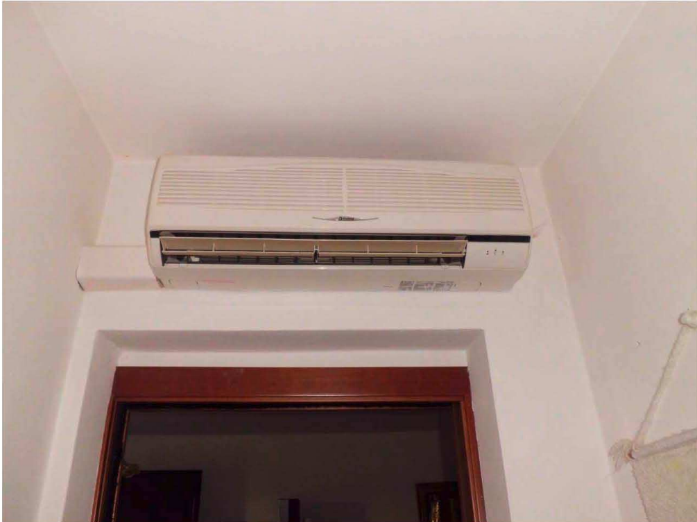
Foto n° 11 - 19/02/2015 - Comune di Pravidomini - Foglio 11 part. 495 sub.10 - Impianto di condizionamento. Split posizionato sopra la porta che collega il soggiorno con il disimpegno reparto notte. La foto è scattata dal disimpegno.
