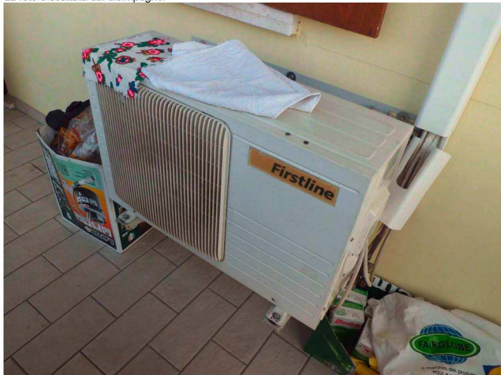
Foto n° 12 - 19/02/2015 - Comune di Pravidomini - Foglio 11 part. 495 sub.10 - Impianto di condizionamento. Particolare del condizionatore posto nella terrazza esterna.
