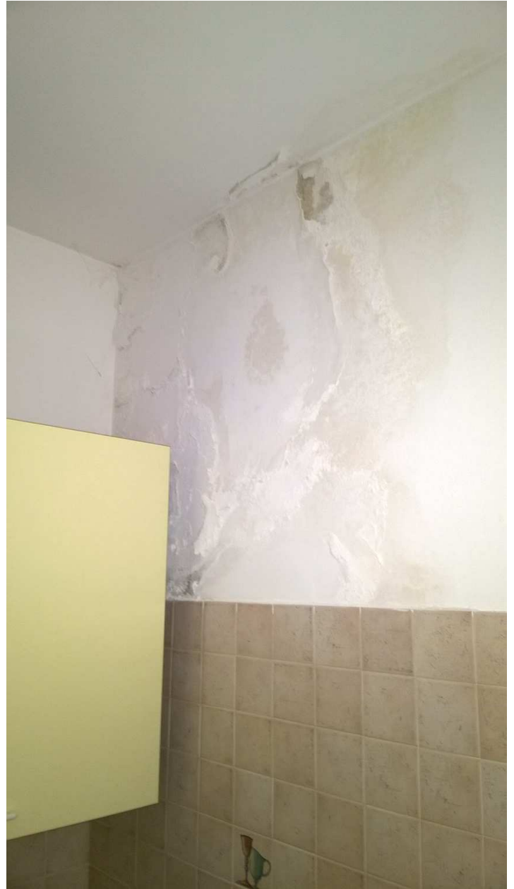
infiltrazione acqua lato cucina terrazzo
