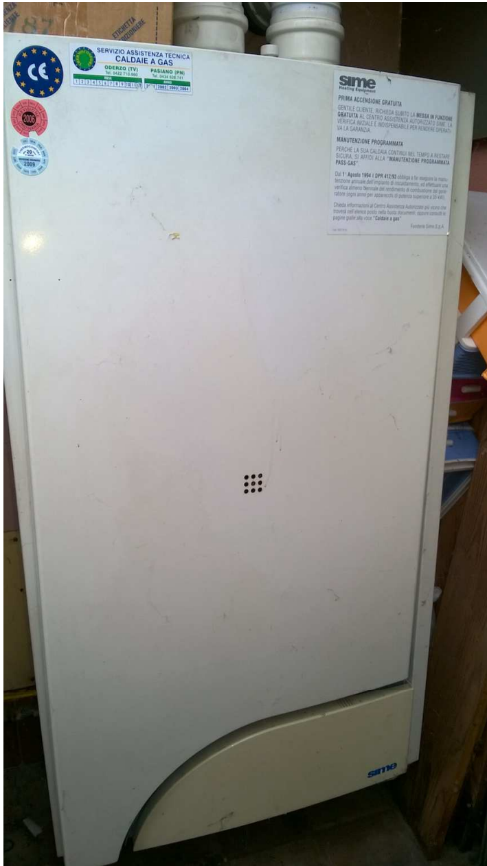
caldaia autonoma dentro pannellatura in alluminio
