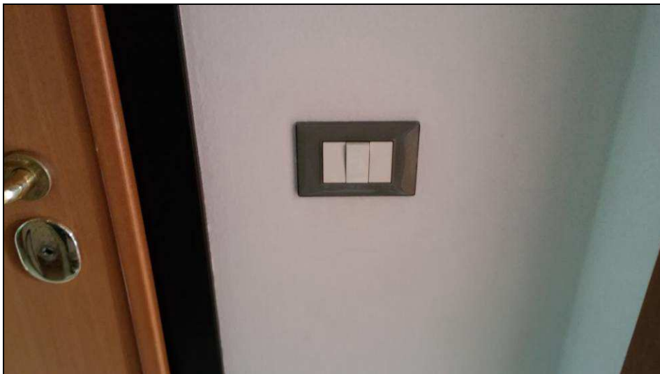
Fig. 8: particolare frutti impianto elettrico
