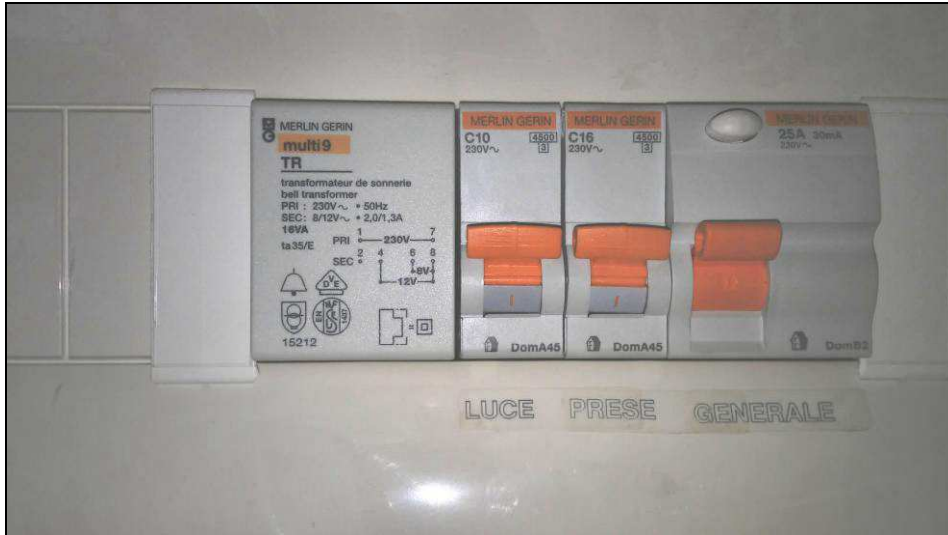
Fig.7: vista quadro elettrico in entrata
