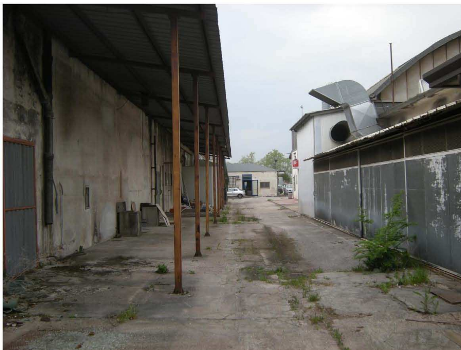
Prata di Pordenone, Particella 629 – Il Silos e la strada di accesso ad esso.
