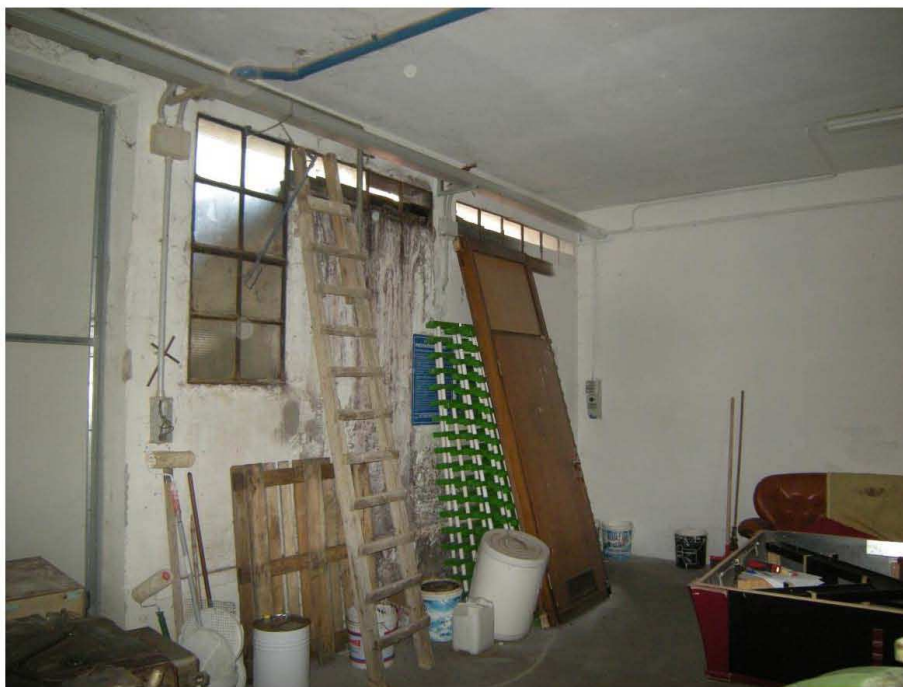
Prata di Pordenone, Particella 629 – La parete sud - ovest del capannone, in basso i danni da infiltrazione di acqua meteorica.
