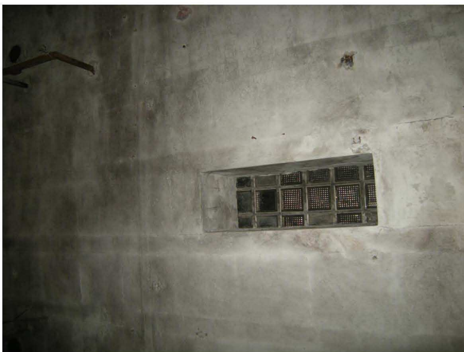
Prata di Pordenone, Particella 629 – Il locale con destinazione d'uso Centrale Termica.
