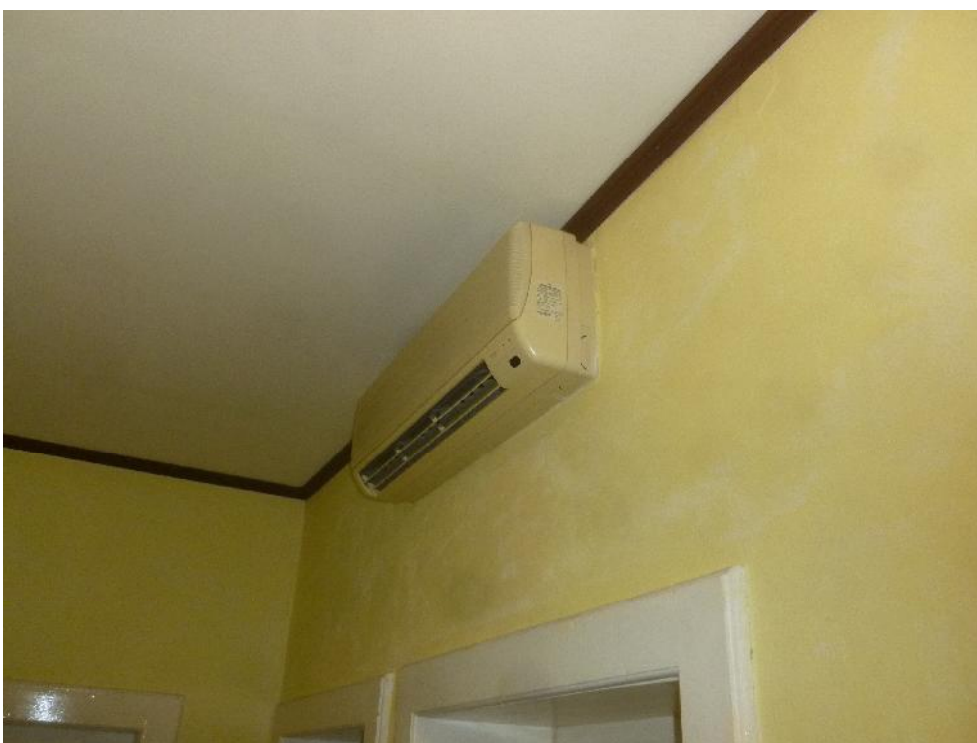
Foto n. 8 – Corridoio con dettaglio impianto di climatizzazione.
