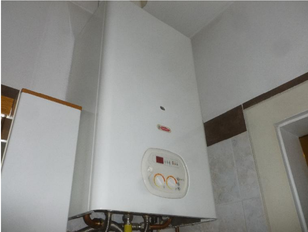
Foto n. 15 – Caldaia murale di fabbricazione “Radiant”
