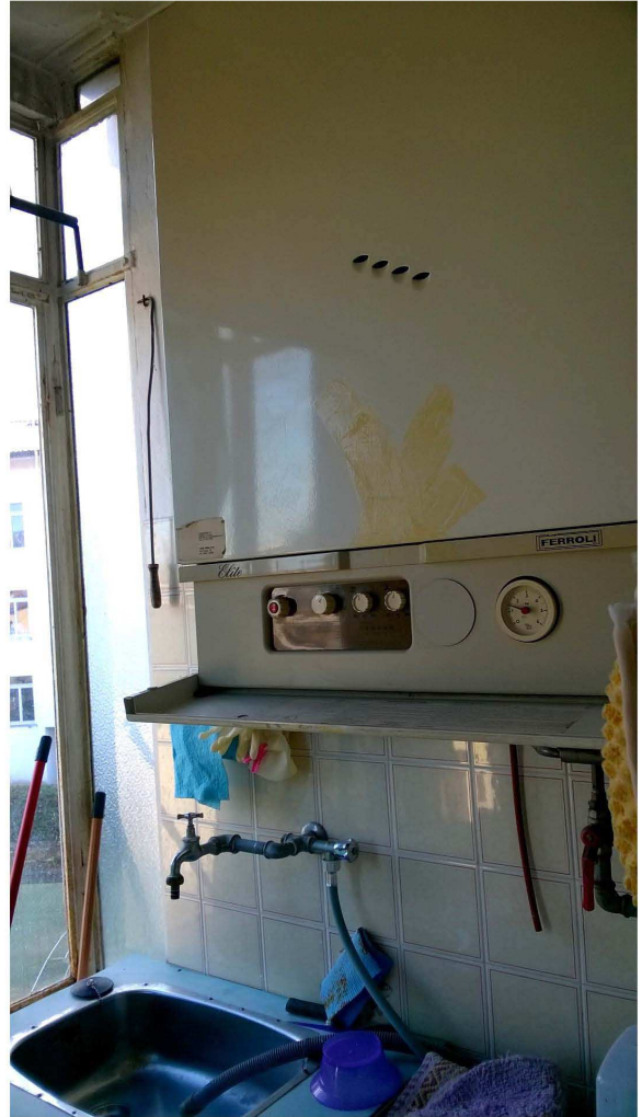
caldaia murale nel terrazzo cucina
