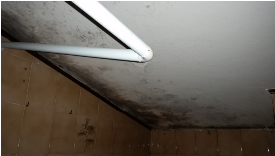
Locale bagno (si noti la muffa sul soffitto)
