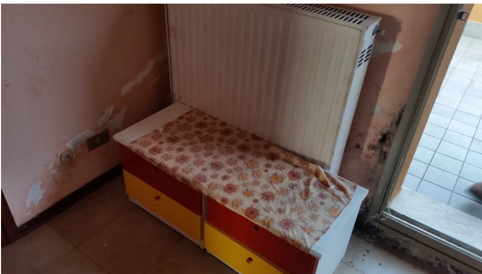
Parete della sala verso la terrazza (si veda la muffa)
