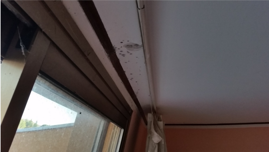
Muffa sul soffitto in prossimità della porta scorrevole
