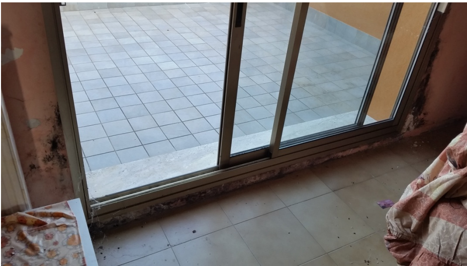
Porte scorrevoli che danno sulla terrazza (si veda la muffa)
