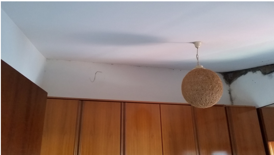
Interno camera da letto (si noti la muffa sulle pareti)
