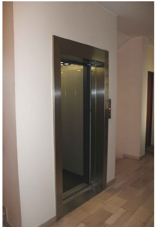
Foto n. 6 – ascensore al piano
