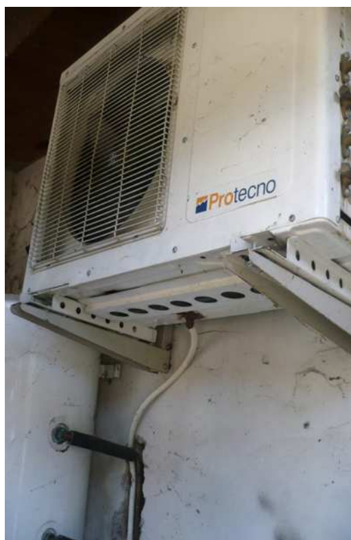
Vano tecnico macchina aria condizionata
