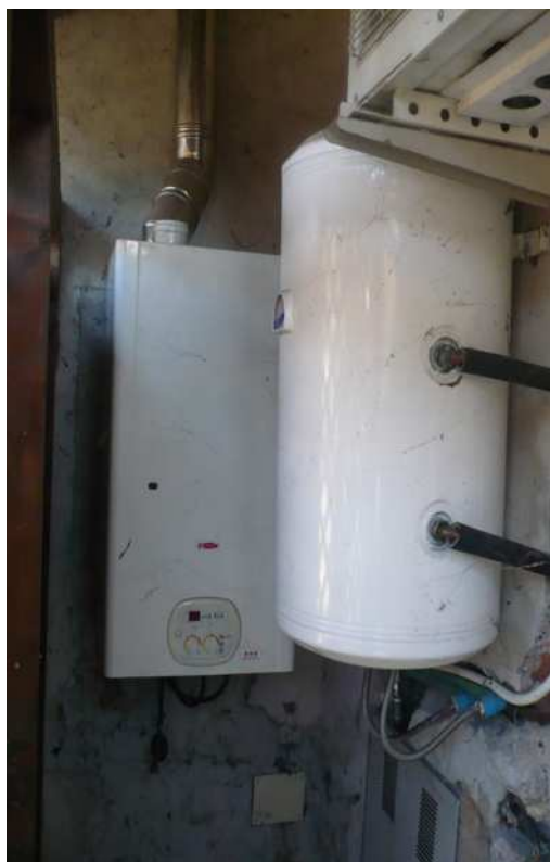
Vano tecnico caldaia riscaldamento
