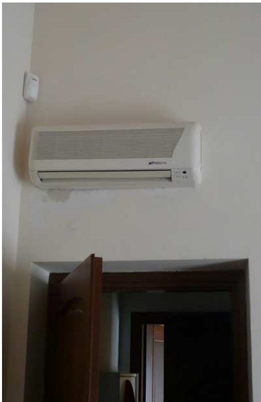
Particolare aria condizionata
