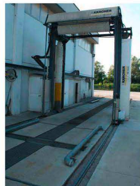
Sistema autolavaggio (n. 79M).
