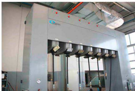
Impianto di erogazione lubrificanti (n. 11M).
