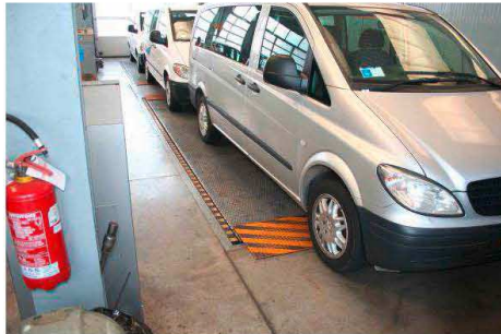
Sollevatore idraulico per autoveicoli (n. 16M).
