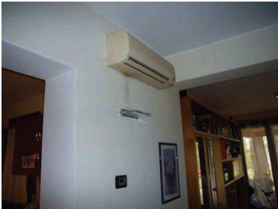
CONDIZIONATORE PIANO TERRA
