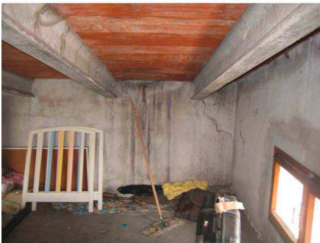
Veduta problematiche soffitta p. 2
