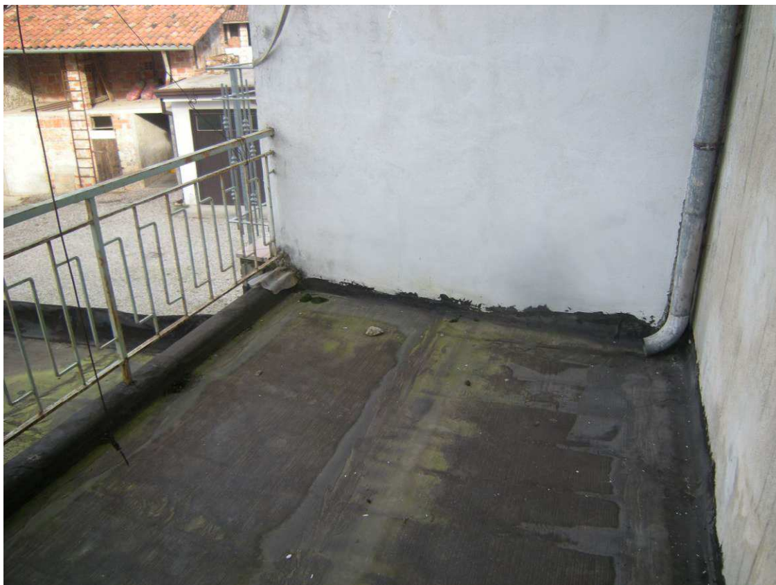
Spilimbergo, Via S. Stefano 16 –Piano Primo - Il terrazzo a livello sul prospetto a nord - ovest.
