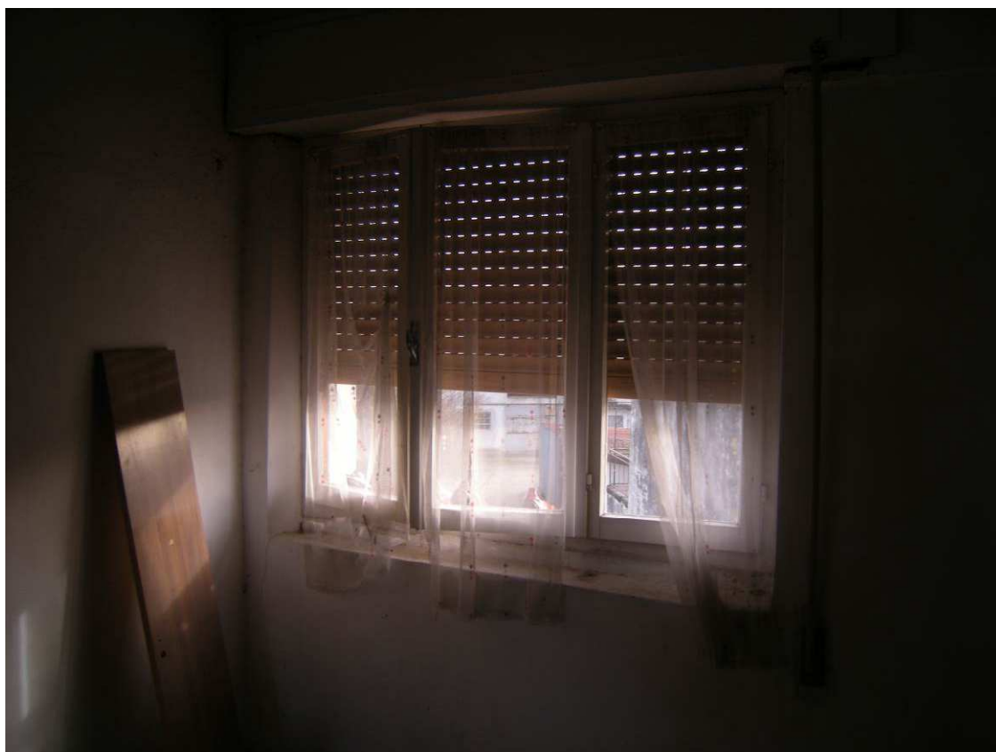
Spilimbergo, Via S. Stefano 16 – Sopra L'interruttore generale dell'impianto elettrico dell'appartamento, sotto gli infissi.
