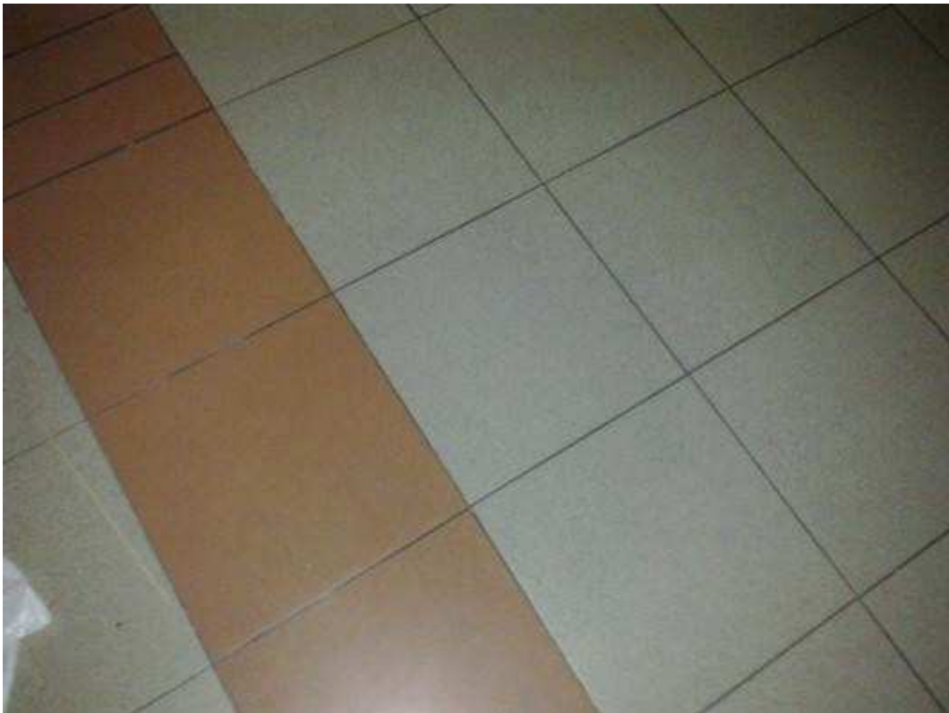
Foto 21 dettaglio pavimenti in piastrelle
