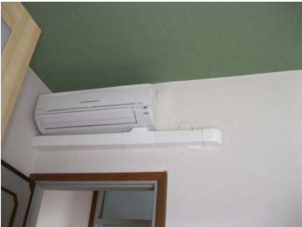
Foto 32 33 dettaglio impianto condizionamento
