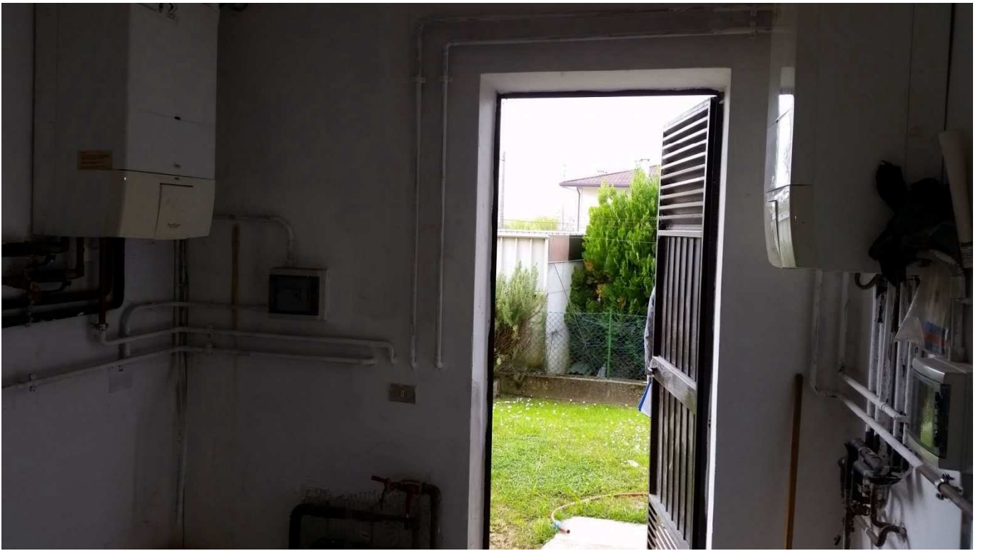
Foto 19 : Centrale Termica comune al Piano Terra.
