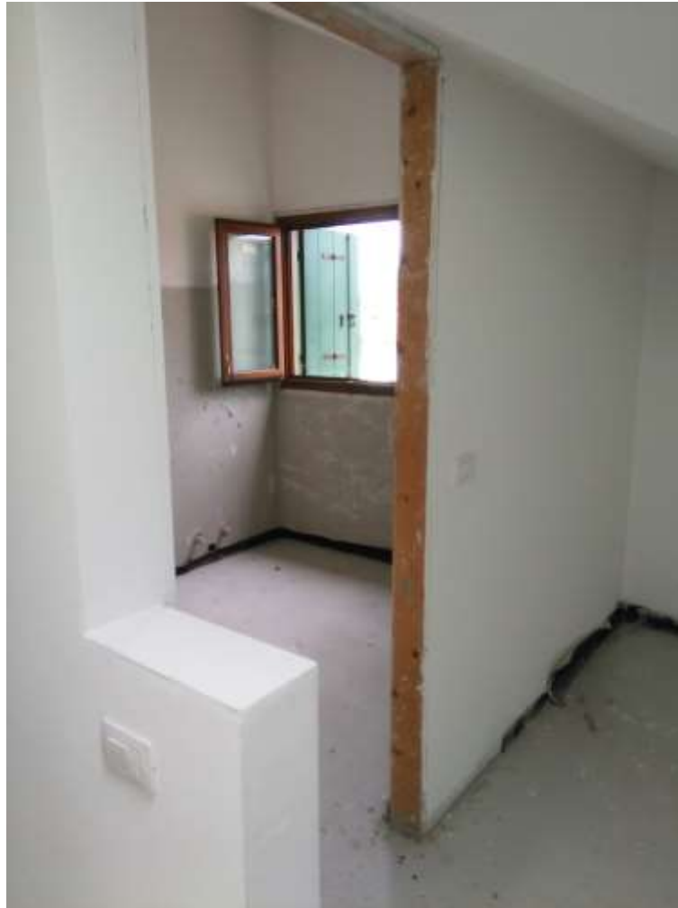
FOTO 19_SOFFITTA_LOCALE CON PREDISPOSIZIONE IMPIANTI BAGNO NON AUTORIZZATO
