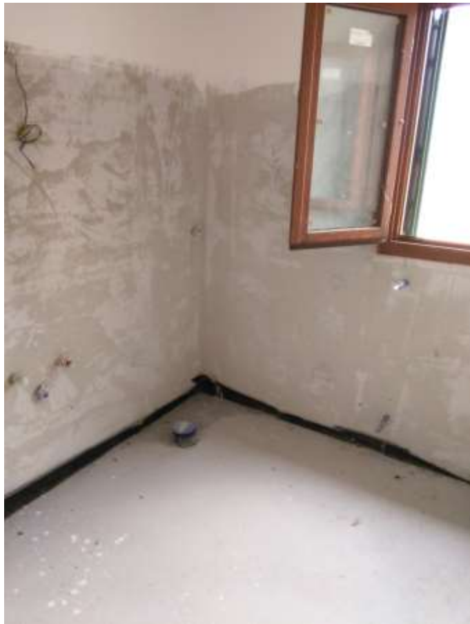
FOTO 20_SOFFITTA_LOCALE CON PREDISPOSIZIONE IMPIANTI BAGNO NON AUTORIZZATO
