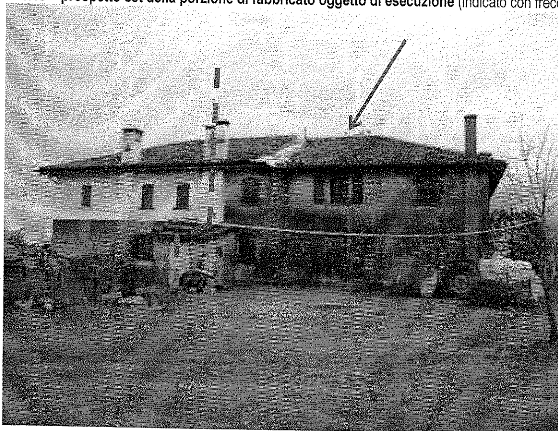
Foto 1.13 – prospetto est della porzione di fabbricato oggetto di esecuzione (indicato con freccia rossa)
