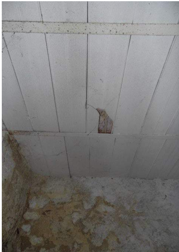
Foto 25: particolare soffitto vano 3 – tavelle
