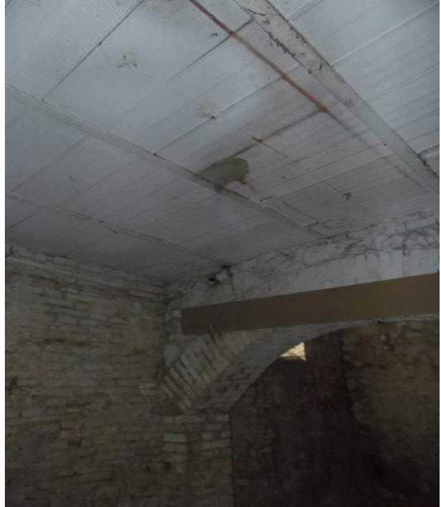
Foto 21: particolare soffitto vano 2 – tavelle
