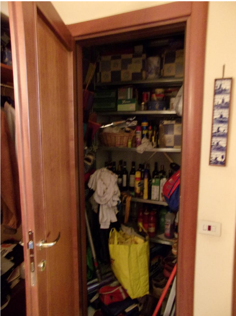
Foto 12: ripostiglio da sanare
