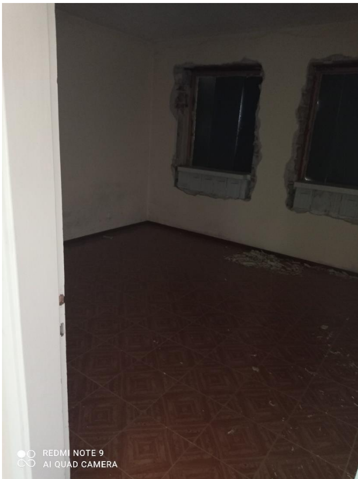
Stato della camera
