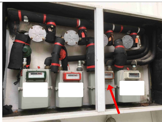
Particolare contatori gas
