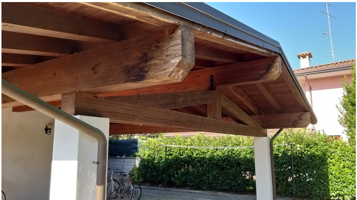
Foto n° 8 – Lotto 1 - Comune di Azzano Decimo (PN) – Foglio 19, m.le 496 sub 3. Particolare di capriata e travi della tettoia di cui alla foto precedente.
