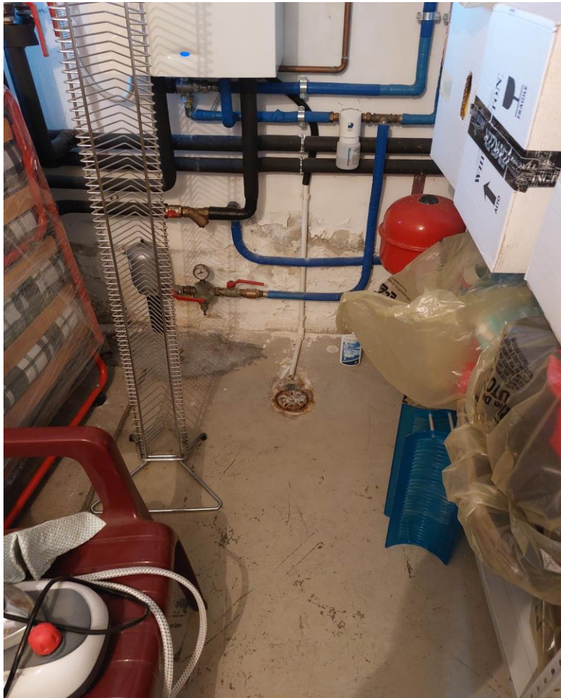
Foto n° 33 - Lotto 1 - 22-07-2022 - Comune di Sequals (PN) - Foglio 10 m.le 381 sub 1. Piano scantinato: veduta interna, dal secondo disimpegno, del vano uso centrale termica.
