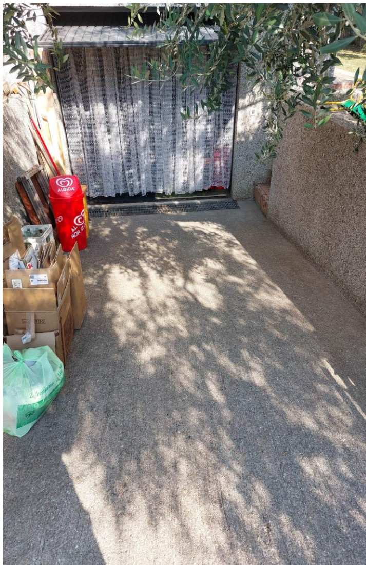
Foto n° 44 - Lotto 1 - 22-07-2022 - Comune di Sequals (PN) - Foglio 10 m.le 381 sub 2. Garage: rampa d'accesso dal- l'esterno.
