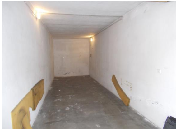
8. Interno del box
