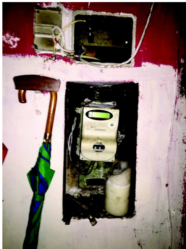
Viste contatore ed imp. elettrico
