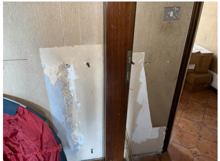
particolare mancanza dei termosifoni nell'appartamento
