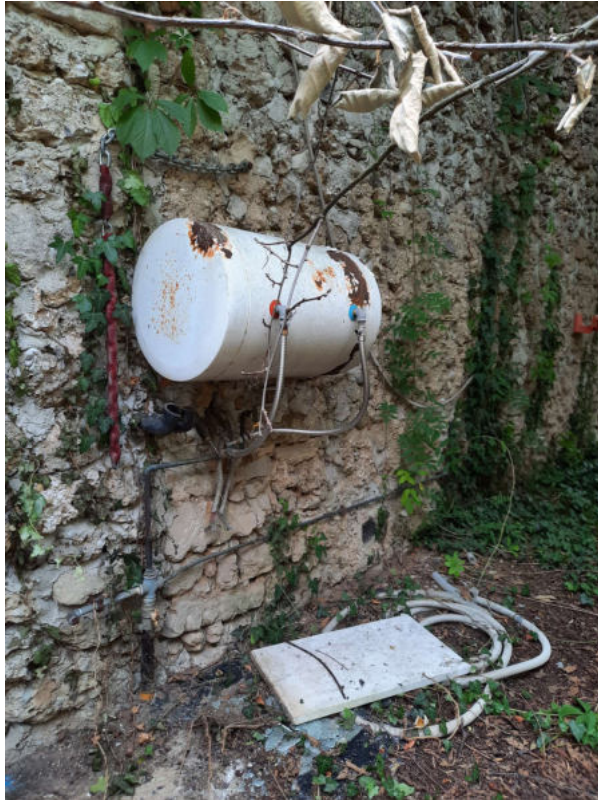
FOTO 11 – Particella 81 sub. 701 boiler elettrico esterno
