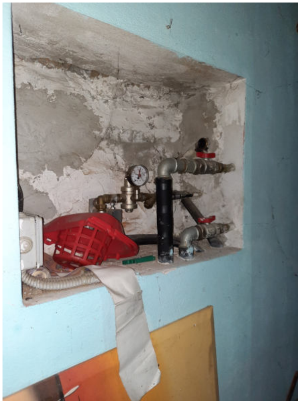
FOTO 12 – Particella 81 sub. 701 predisposizione impianto interno
