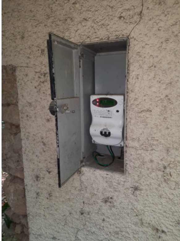
FOTO 9 – Contatore elettrico esterno
