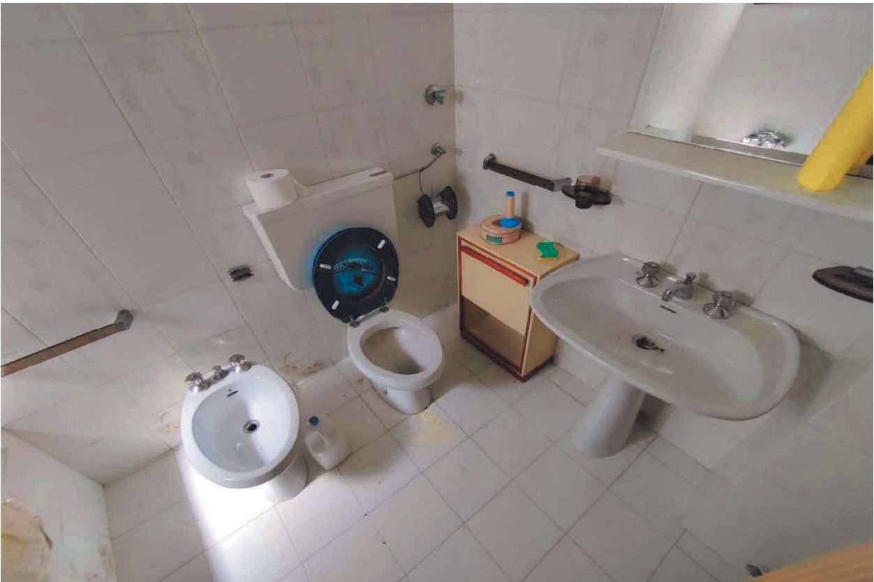
Foto n. 16 – Servizio igienico al piano primo.
