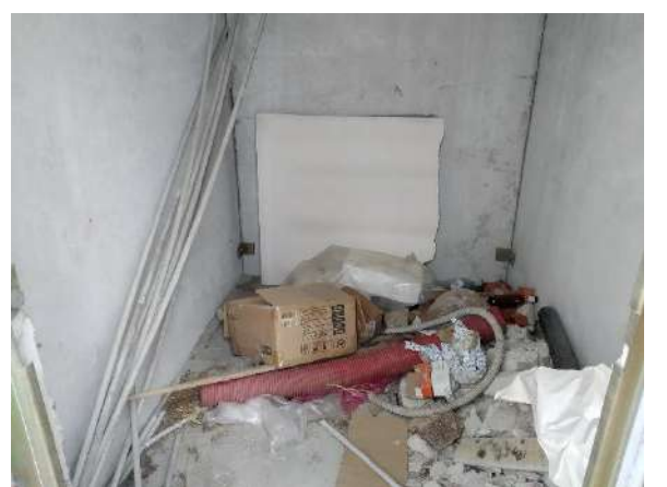
Fig. 19: cabina elettrica interno
