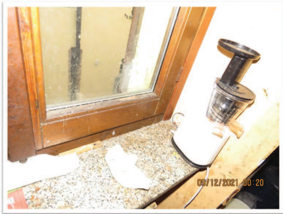
Particolari di degrado.
