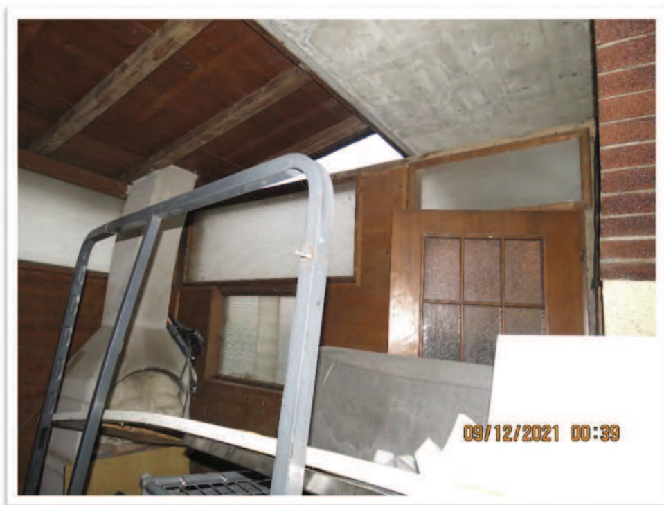
La costruzione abusiva al piano terreno.
