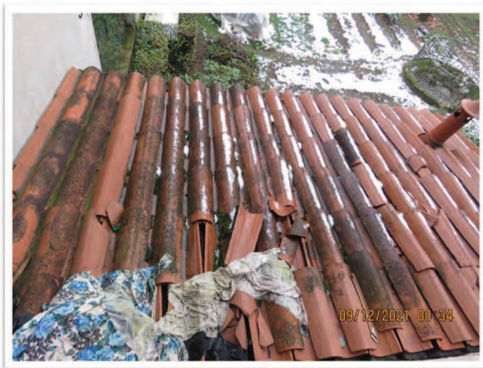
Particolari di degrado.
