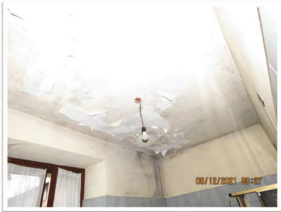
Particolari di degrado.
