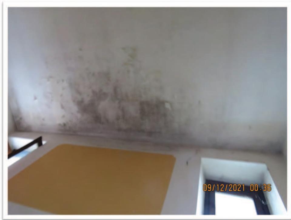
Particolari di degrado.
