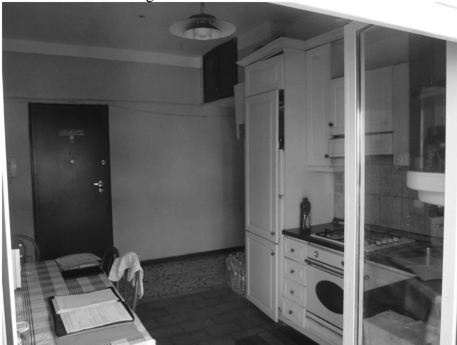
Foto 11: cucina (manca muro divisorio verso ingresso)
