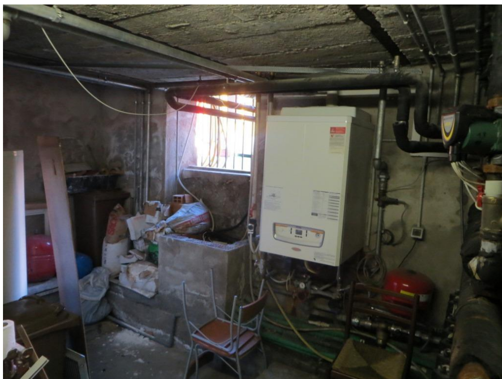
Foto 116 – Locale caldaia (sub 701 - Bene comune non censibile)
