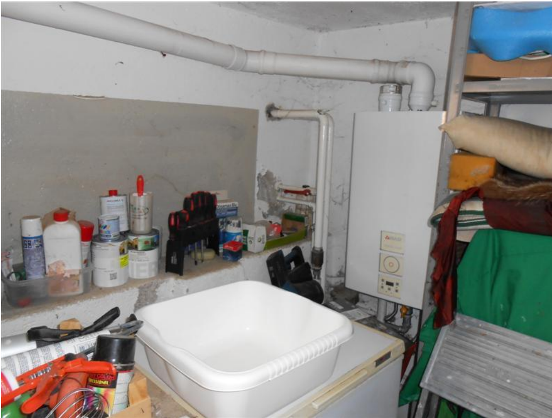
120) Particolari centrale termica
