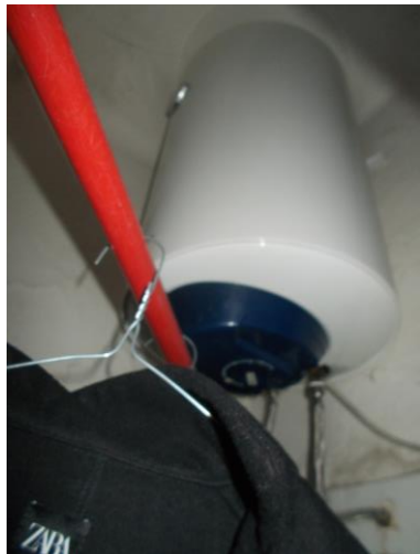
17. Boiler all'interno della doccia
