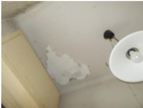
29. Soffitto del locale cottura
