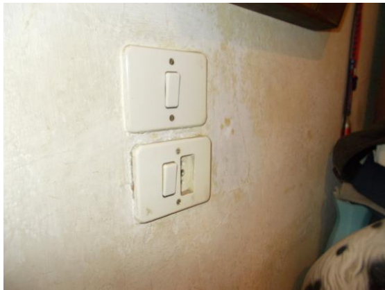
23. Dettaglio componente elettrica
