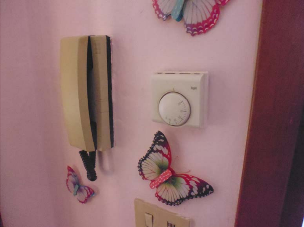
Particolare citofono e termostato ambiente
