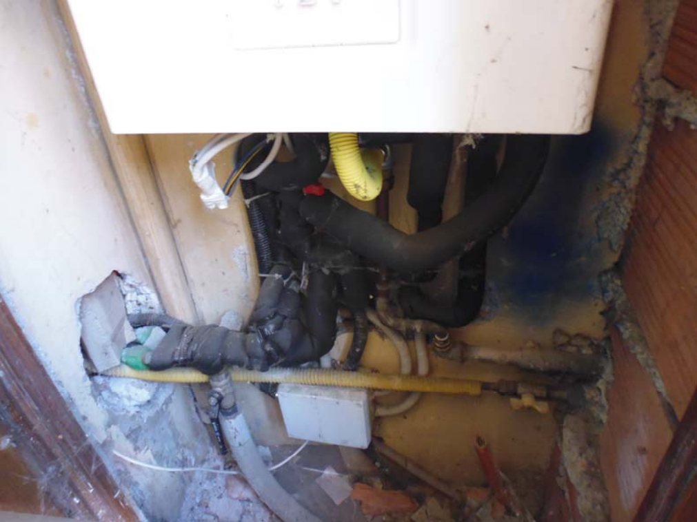
Particolare collettori caldaia
