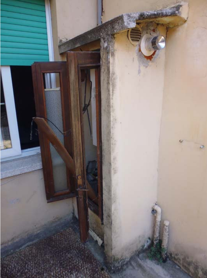
Particolare vano caldaia esterno
