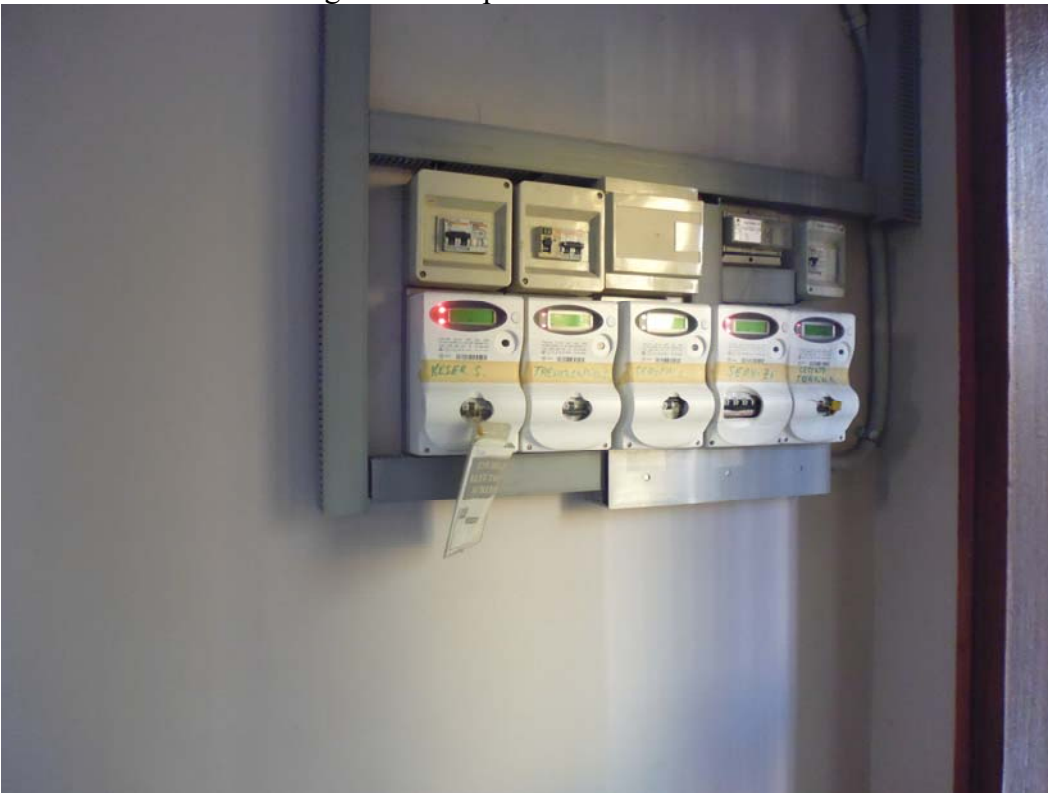
Particolare contatori energia elettrica posti in androne
