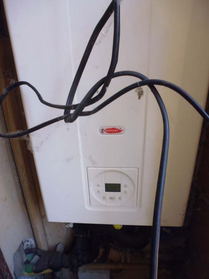
Particolare caldaia esterna
