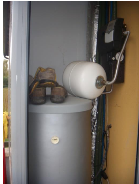
IMMOBILE F. 7 MAPP. 466 SUB. 7- Locale caldaia
