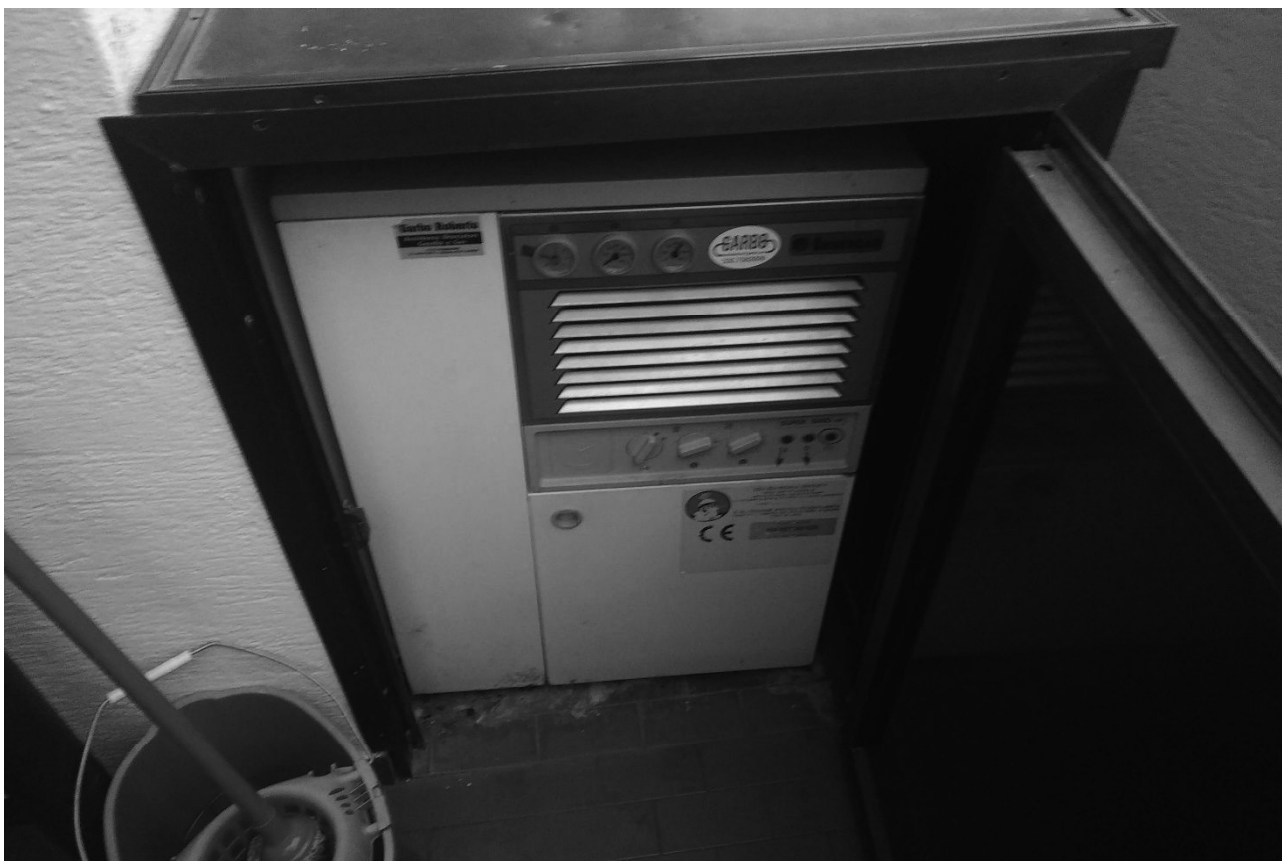
Foto n. 35 – Centrale termica Immergas Super Sirio.
