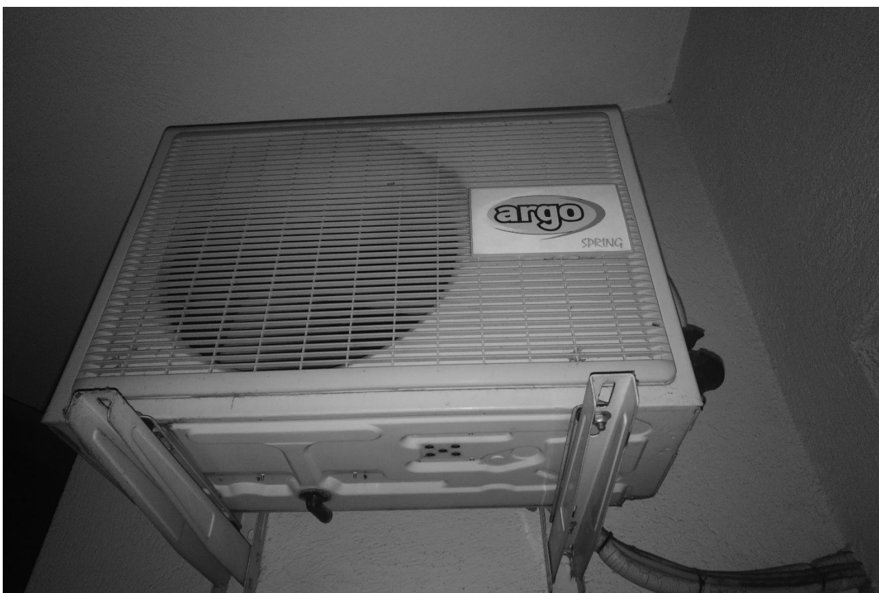
Foto n. 36 – Unità esterna climatizzatore.
