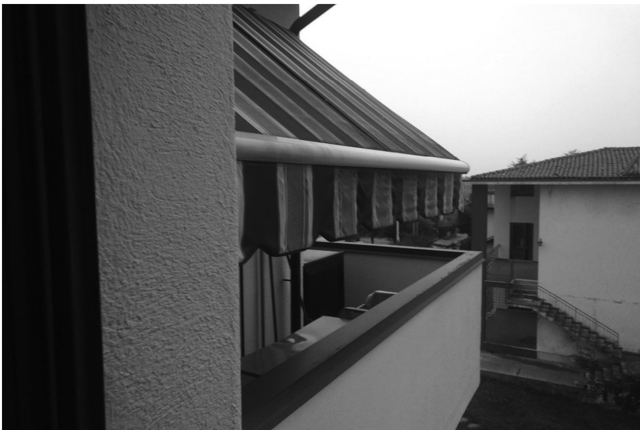
Foto n. 34 – Balcone della cucina dove è alloggiata la centrale termica a gas.
