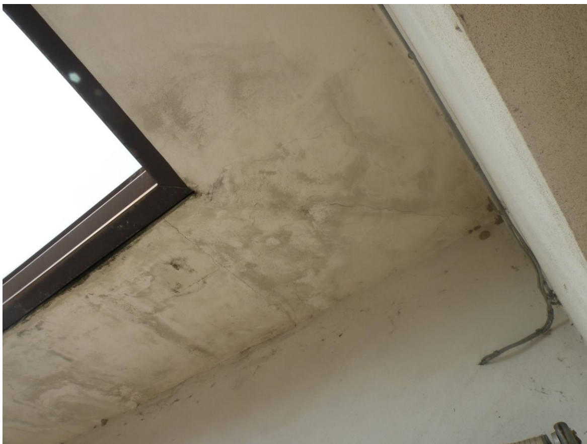
30 - infiltrazioni dal tetto
