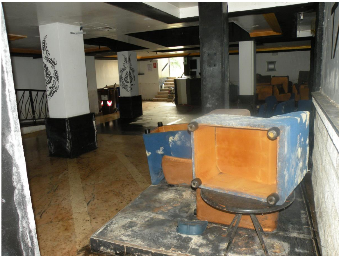
9 - presenza di forte umidità
