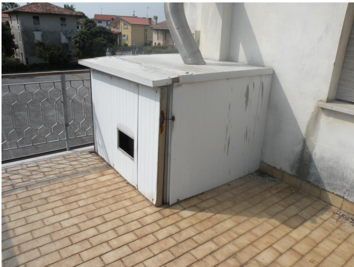
31 - ubicazione del generatore di calore
