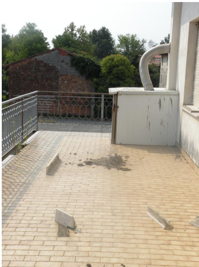
32 - terrazza e ubicazione del generatore di calore
